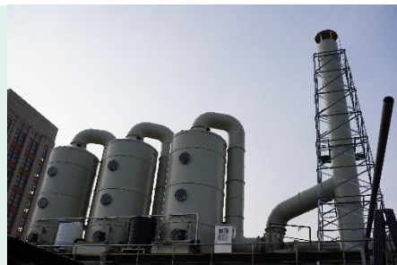
亞東常州污水站廢氣處理裝置改造後
