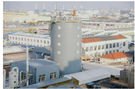
亞東常州污水站厭氧塔
