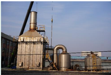
亞東常州污水站廢氣處理裝置改造前
